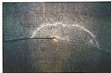
写真 2 半月状のひび割れ
