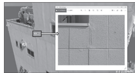
図5：当社 社屋 (損傷箇所のポップアップウィンドウ)
